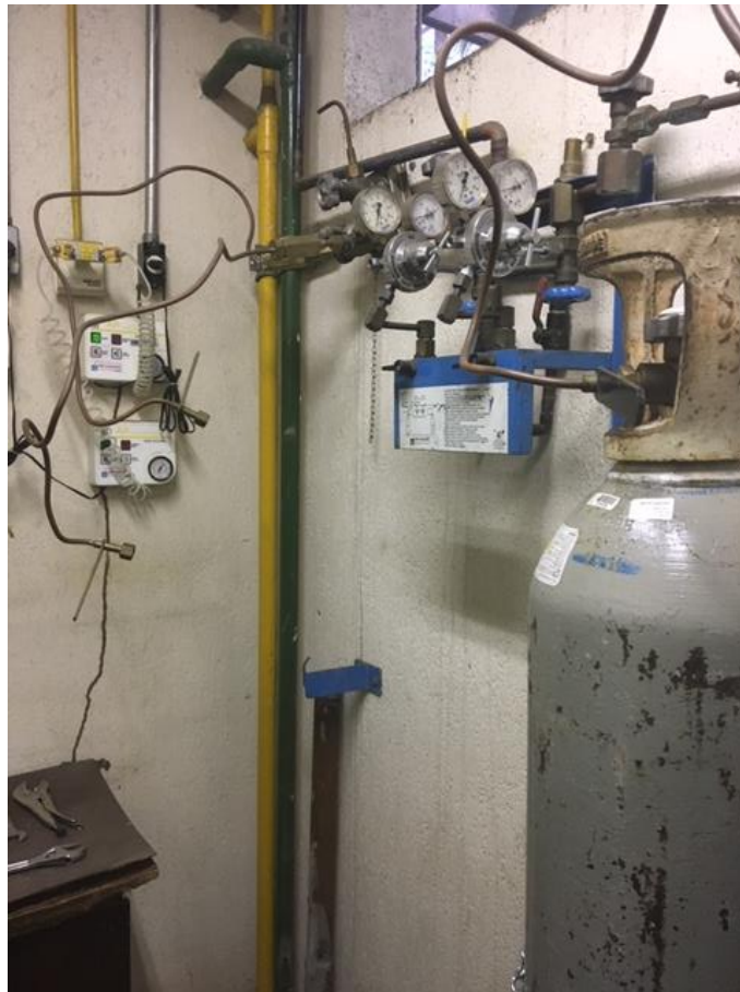
Figura 2 – Baterias de óxido nitroso desativadas
